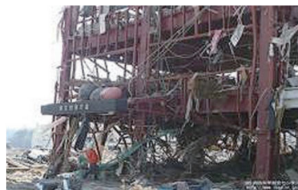
南三陸町役場の被災状況 (消防科学総合センター提供)
